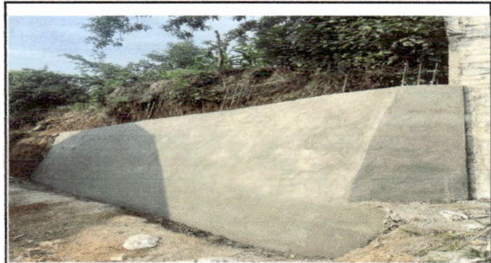
Foto 4: Reparación de muro de contención EORM del Paraje El Pito, Aldea Subchal.
