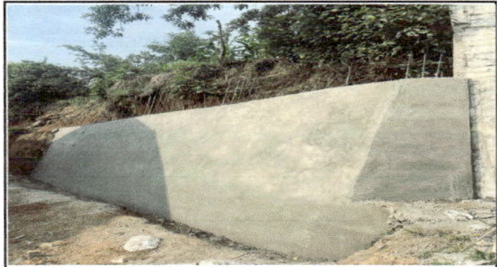
Foto 2: Reparación de muro de contención EORM del Paraje El Pito, Aldea Subchal.
